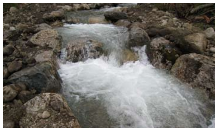
I et sideløp i Aurlandselva er flere terskler reetablert for å øke vanndekt areal og oppvekstområde for fisk.
