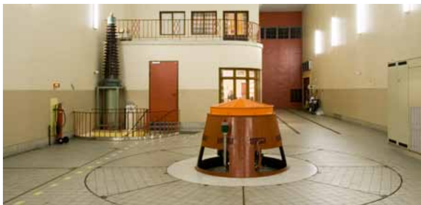
I 2011 ble det tredje av i alt fire aggregater oppgradert i kraftstasjonen Hol 1.
